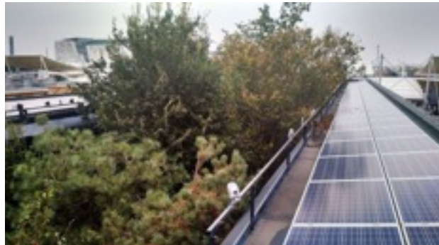
Fig. 16 - Placas solares na cobertura. Foto da autora.
